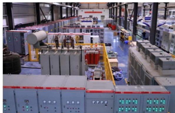
● 高压大功率电力电子测试室
