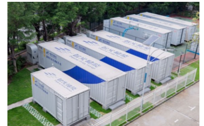
5MW 储能实验平台
