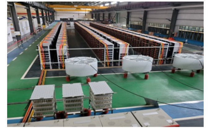
35kV 级联高压储能系统
