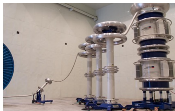
● 电缆高压局放测试实验室
